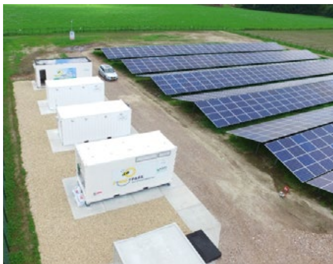
Figuur 2: Deel van zonnepark Altweerterheide met de containers waarin de batterijen, omvormers en vergader ruimte te vinden zijn.
